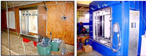
FANS Unit Testing Tunnel Fan
